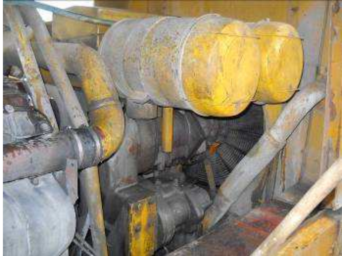
Photo: Hier sind die Luftfilter der Anlage.
